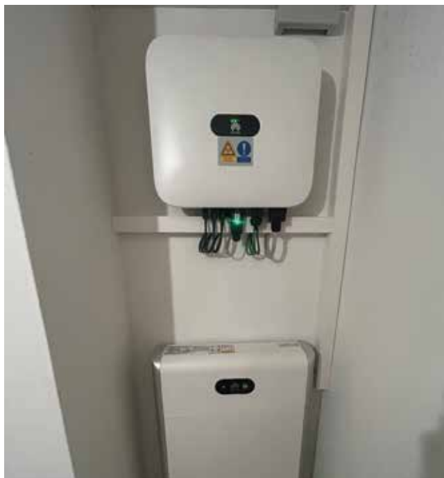
D'Installatioun hélt net vill Plaz an: uewen de Wiesselrichter vun der Photovoltaik-Anlag an ënnen d'Batterie vun 10kWh. L'installation ne prend pas beaucoup de place : en haut l'onduleur de l'installation photovoltaïque et en bas la batterie de 10 kWh.
